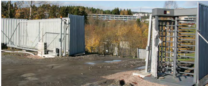
Området er klaggjort med ferdig montert skyvegrind og rotasjonsgrind for trygg helhetssikring.
