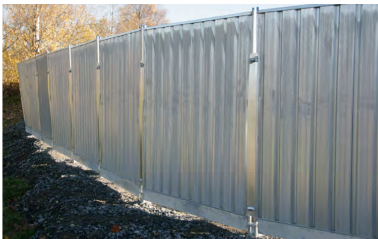
Tette byggegjerder med høyde 2,4 m. Plater er montert under og mellom gjerdene for å tette åpningene.
