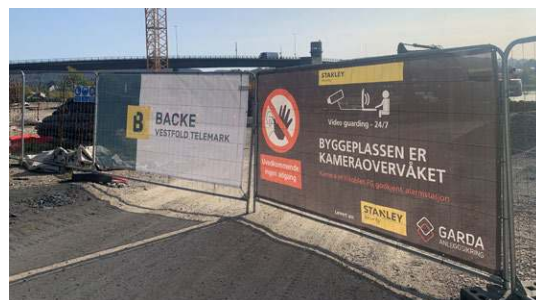
Tydelig merking/varsling er et effektivt, forebyggende tiltak.
